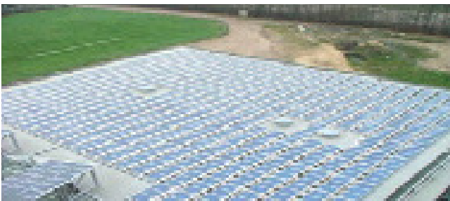
Dak met p.v.- zonnepanelen
