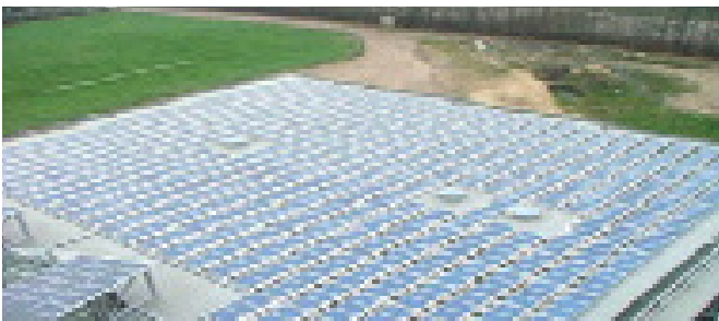
Dak met p.v.- zonnepanelen
